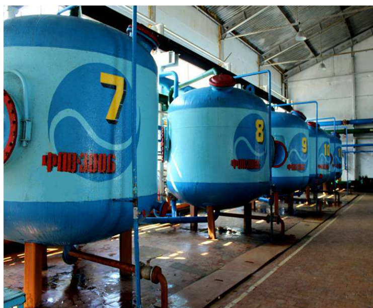
Рисунок 1.3 – Вид фильтровального зала №3
