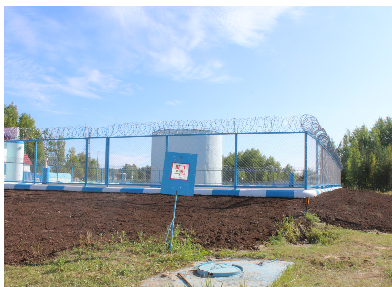
Рисунок 1.4 – Общий вид надземного и подземного резервуаров питьевой воды
