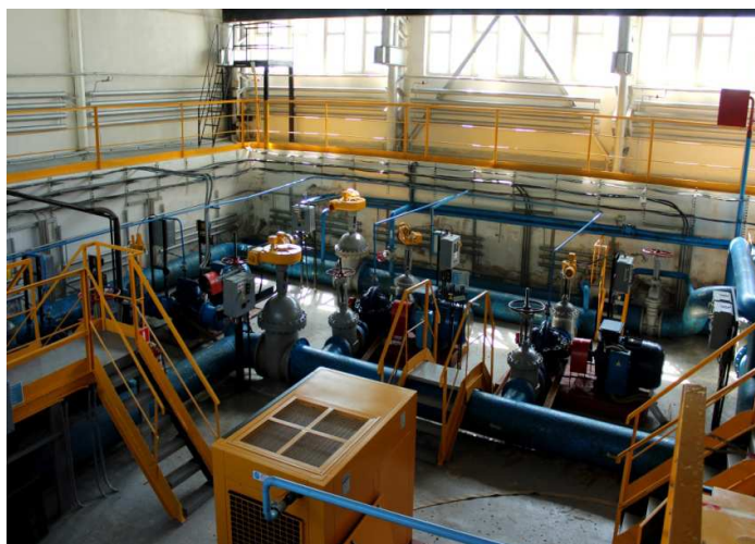
Рисунок 1.12 – Общий вид насосной станции №2
